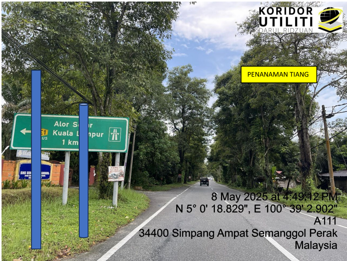
LOKASI DI JALAN SEMANGGOL – CHANGKAT LOBAK
