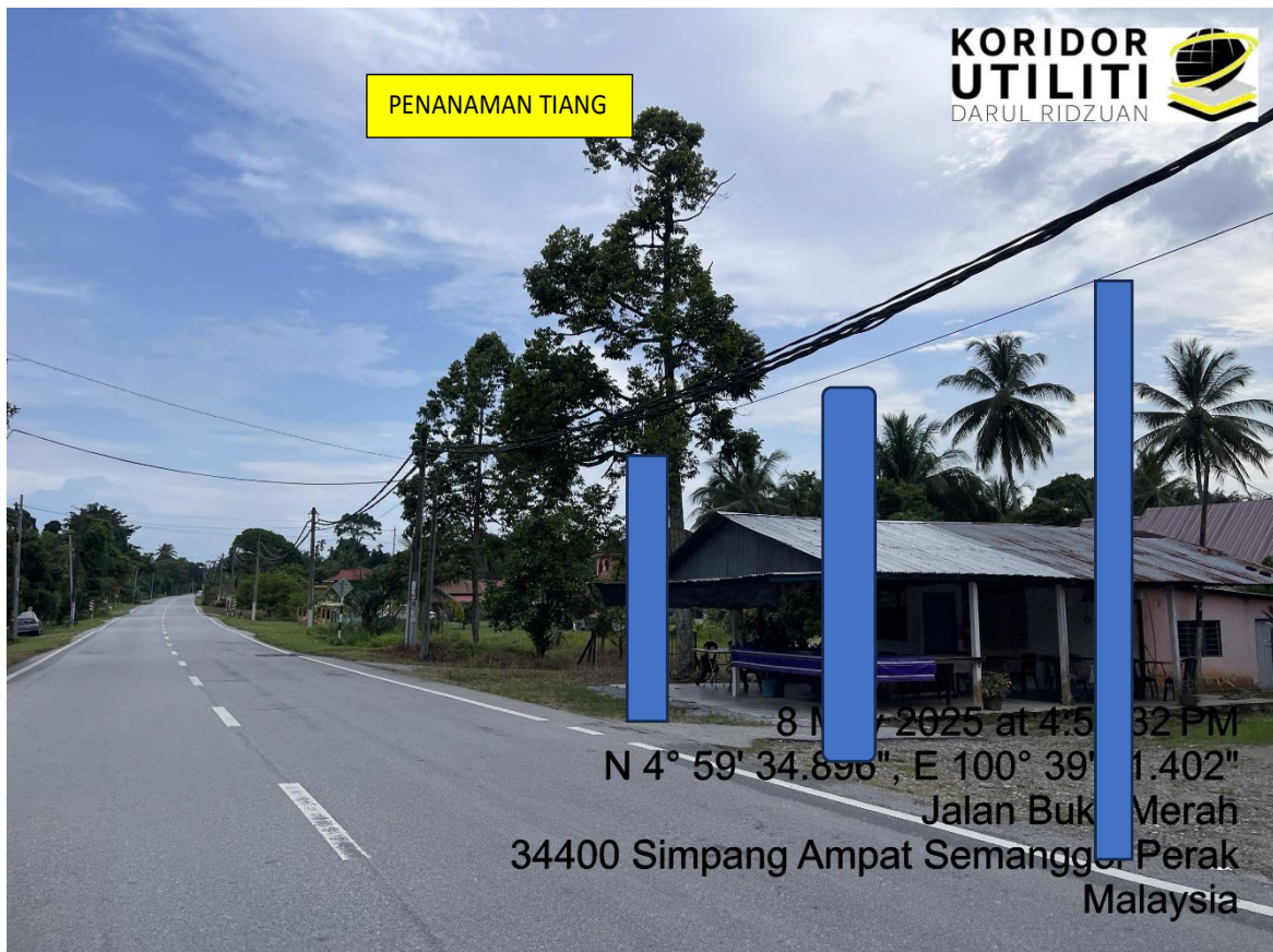
LOKASI DI JALAN SEMANGGOL – CHANGKAT LOBAK
