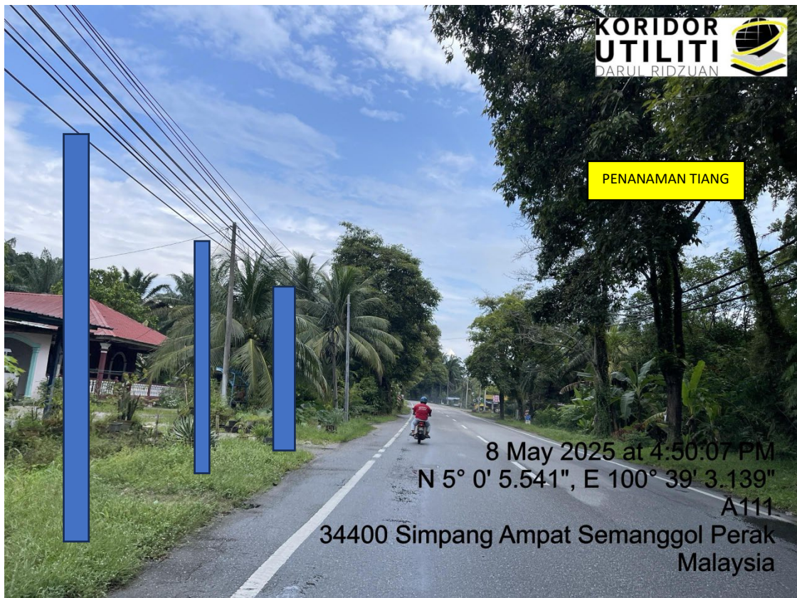
LOKASI DI JALAN SEMANGGOL – CHANGKAT LOBAK
