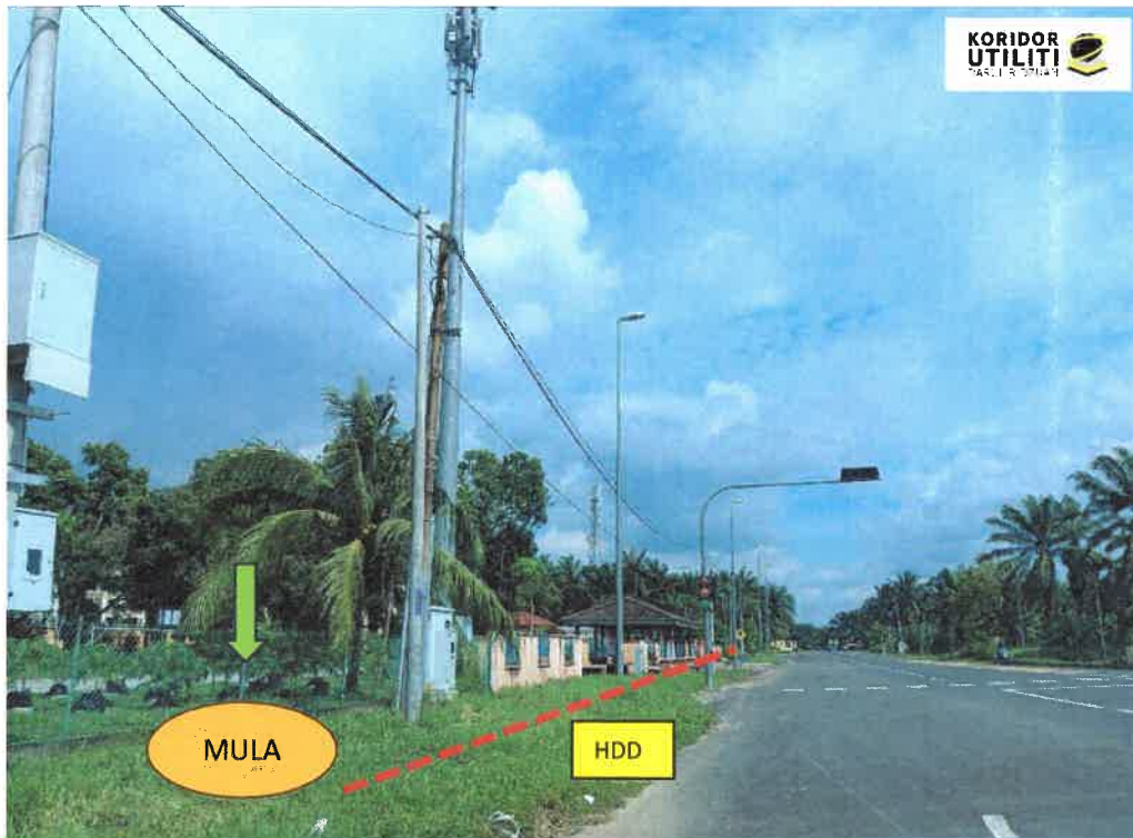
LOKASI DI JALAN SIPUTEH-BATU HAMPAR FT063
