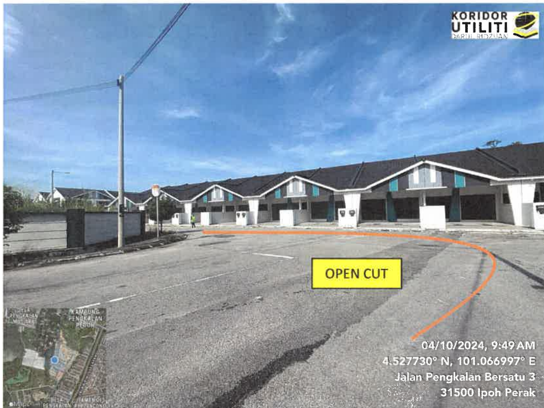
KOREKAN TERBUKA 139 METER
