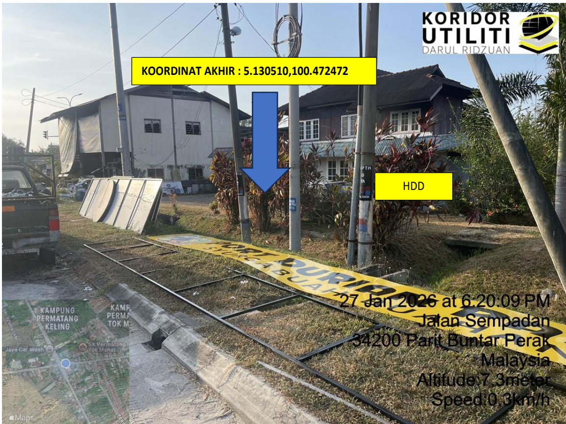
LOKASI DI JALAN PADANG
