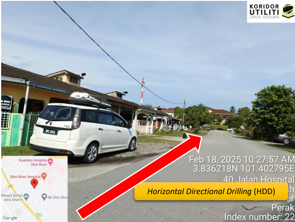
LOKASI DI JALAN JAMBU MERAH, KOREKAN HORIZONTAL DIRECTIONAL DRILLING (HDD), KAWASAN MDTM
