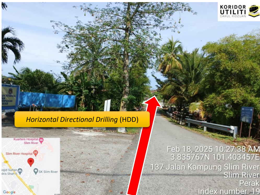
LOKASI DI JALAN JAMBU MERAH, KOREKAN HORIZONTAL DIRECTIONAL DRILLING (HDD), KAWASAN MDTM
