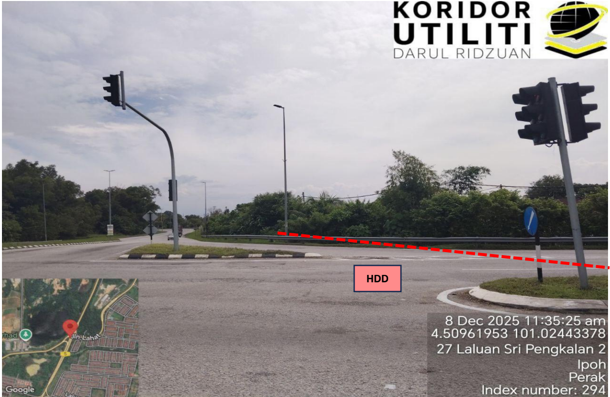
LOKASI KERJA-KERJA KOREKAN HDD CROSSING DARI LALUAN SRI PENGKALAN 2 KE IPOH-LUMUT HIGHWAY (FT5)
