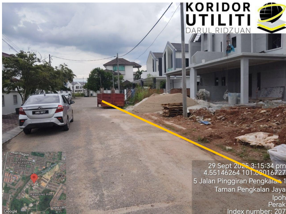
KOREKAN TERBUKA DI JALAN BERTURAP
