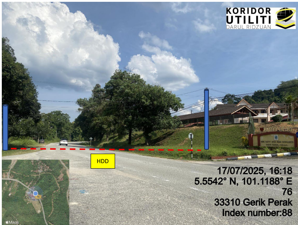
LOKASI DI JALAN JALAN BALING – KUALA KANGSAR
