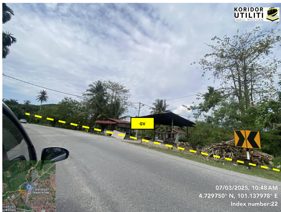
JAJARAN KOREKAN TERBUKA JALAN TIDAK BERTURAP DI JALAN CHEMOR – ULU KUANG (A160)
