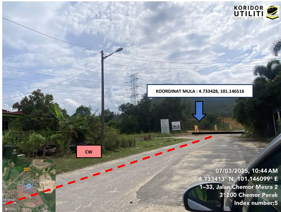
LOKASI KOORDINAT MULA KOREKAN TERBUKA DI JALAN CHEMOR MESRA
