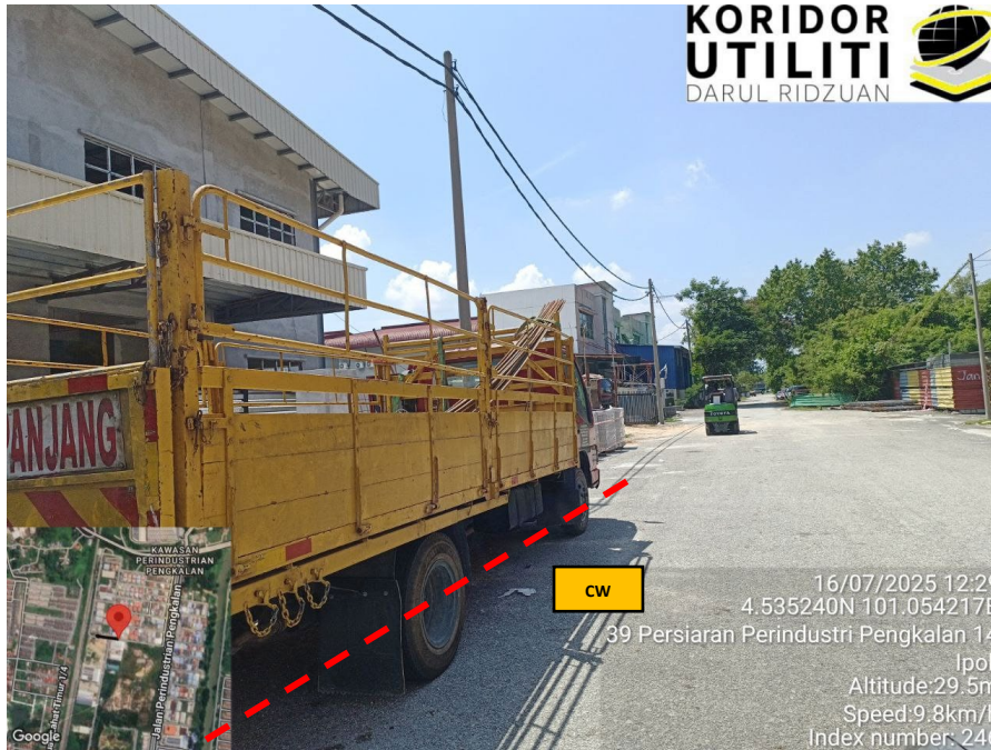
JAJARAN KOREKAN TEERBUKA DI PERSIARAN PERINDUSTRI PENGKALAN 14
