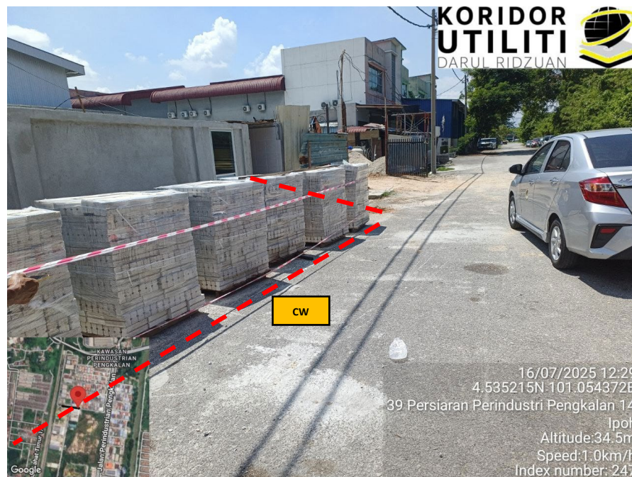
JAJARAN KOREKAN TEERBUKA DI PERSIARAN PERINDUSTRI PENGKALAN 14
