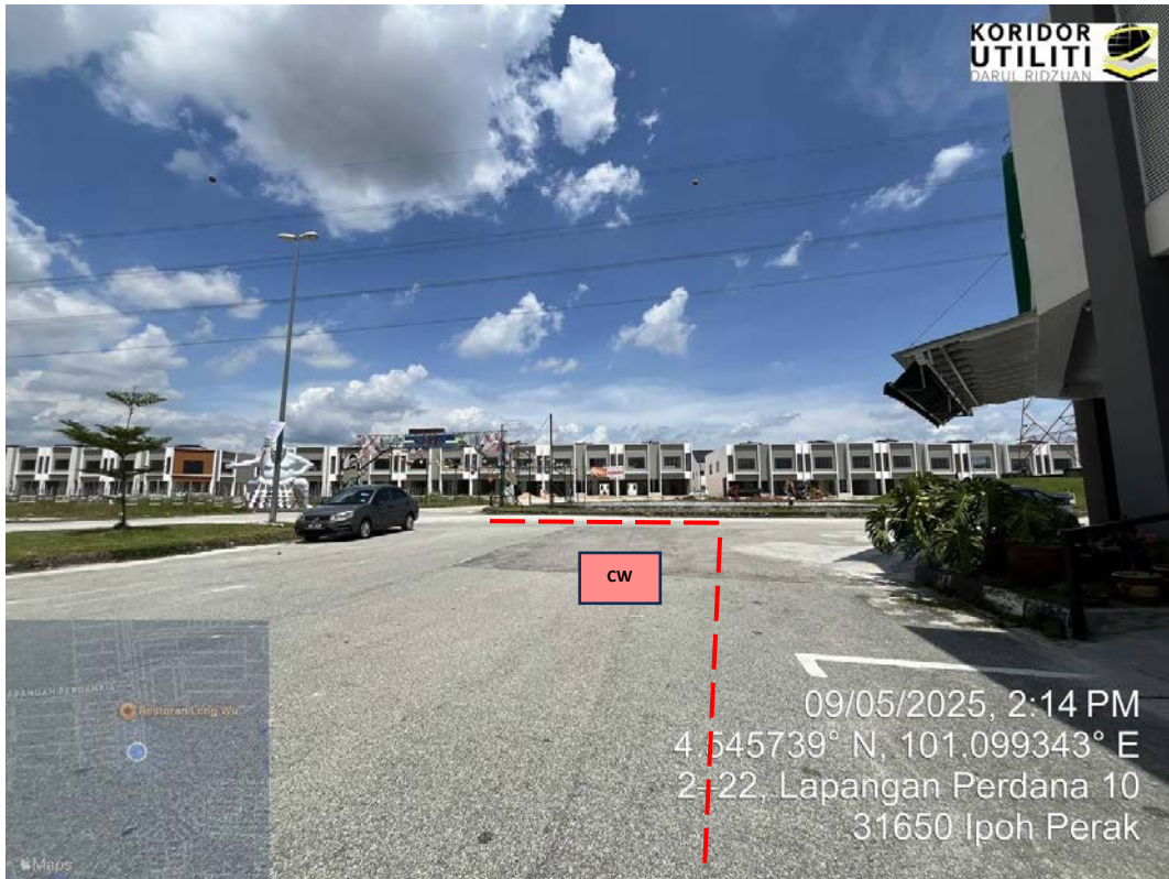
JAJARAN KOREKAN TERBUKA DI LAPANGAN PERDANA 10 (Sambungan akan dibuat dari Manhole Sedia Ada ke Manhole Cadangan)
