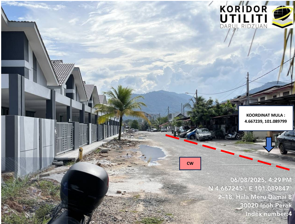
LOKASI KOORDINAT AWAL & JAJARAN KOREKAN TERBUKA DI HALA MERU DAMAI 8
