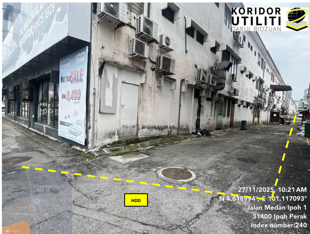
LOKASI KOREKAN HDD DI JALAN MEDAN IPOH 1E (LORONG BELAKANG)
