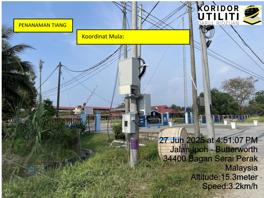
LOKASI DI JALAN BAGAN SERAI – TAIPING
