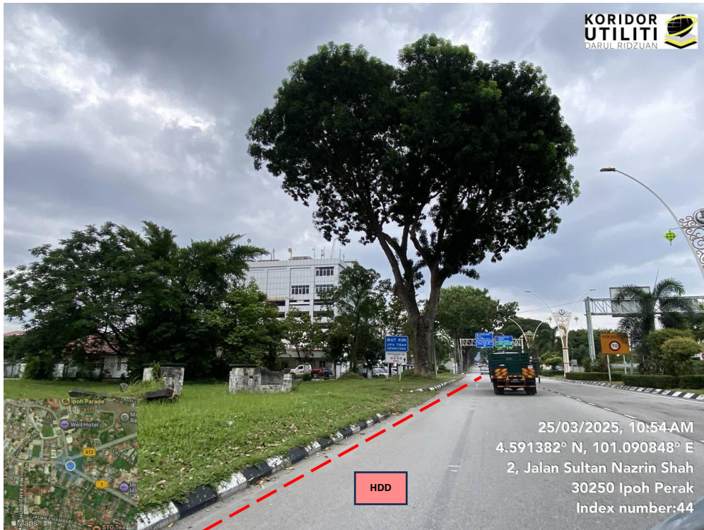
JAJARAN HDD DI JALAN SULTAN IDRIS SHAH (Sambungan akan dibuat daripada PPU Hospital Bainun ke IPO 5448)
