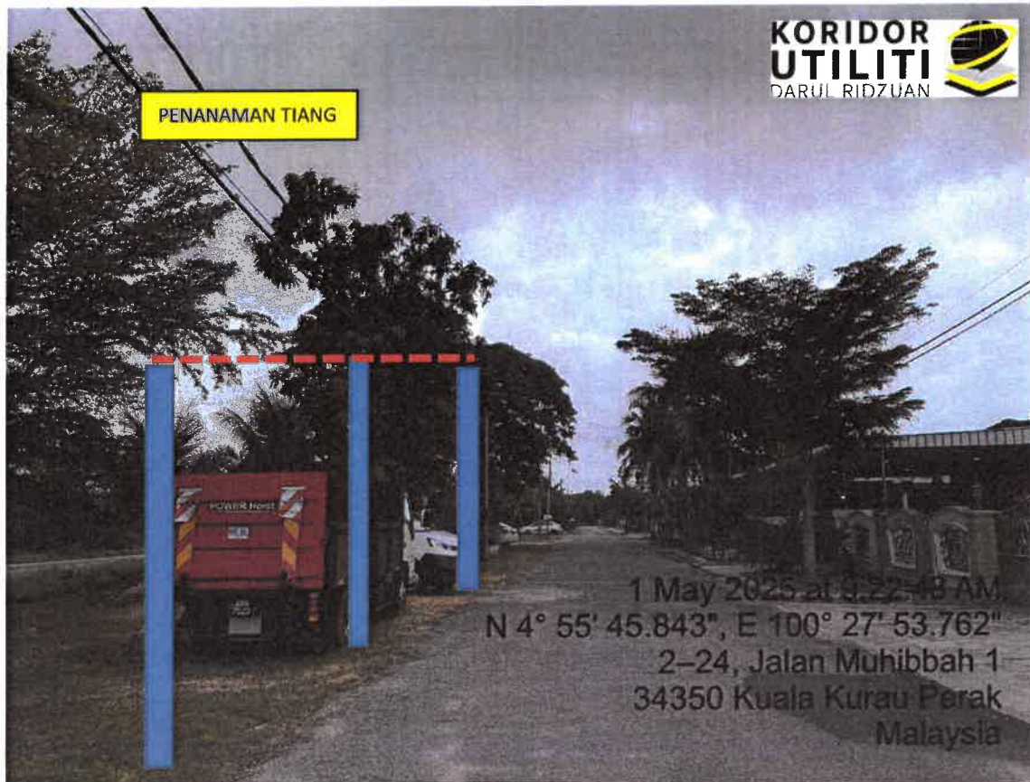
LOKASI DI JALAN TAMAN MUHIBAH
