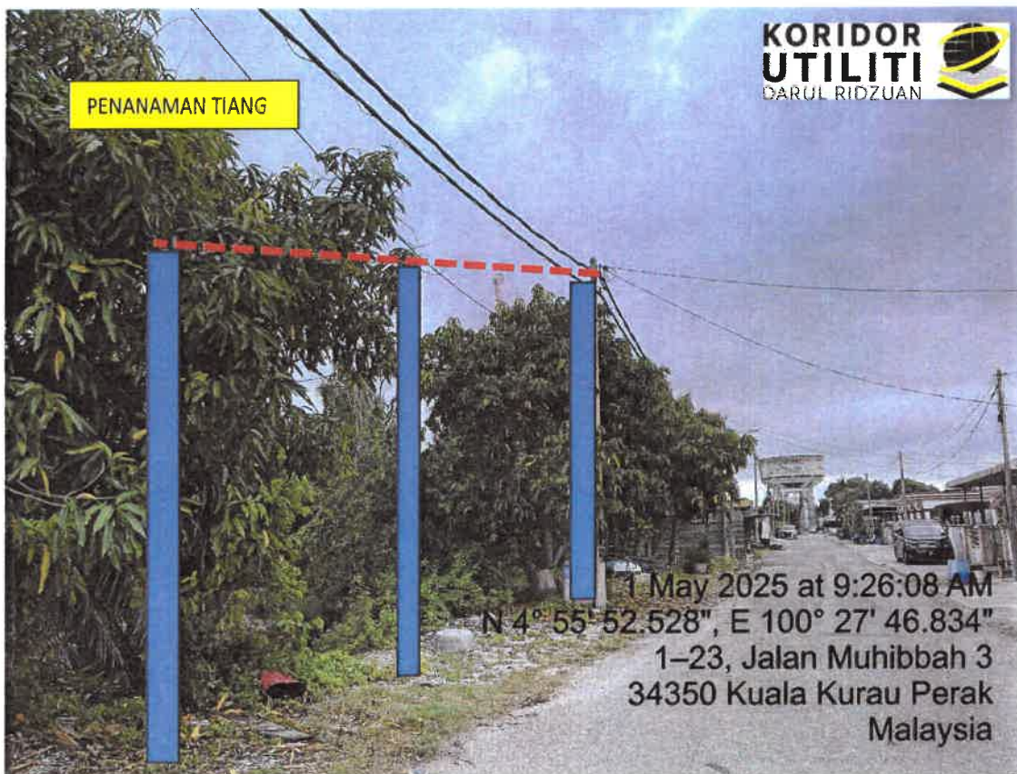
LOKASI DI JALAN TAMAN MUHIBAH
