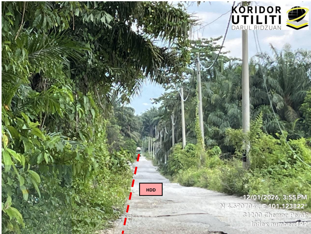
JAJARAN KERJA DI JALAN TIDAK DAPAT DIKENALPASTI (JALAN MILIK JKR)
