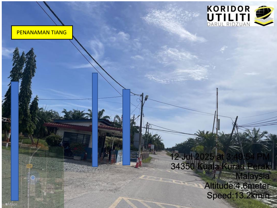
LOKASI DI JALAN GULA
