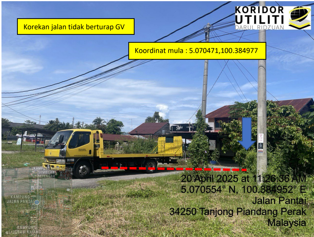
LOKASI DI JALAN PANTAI
