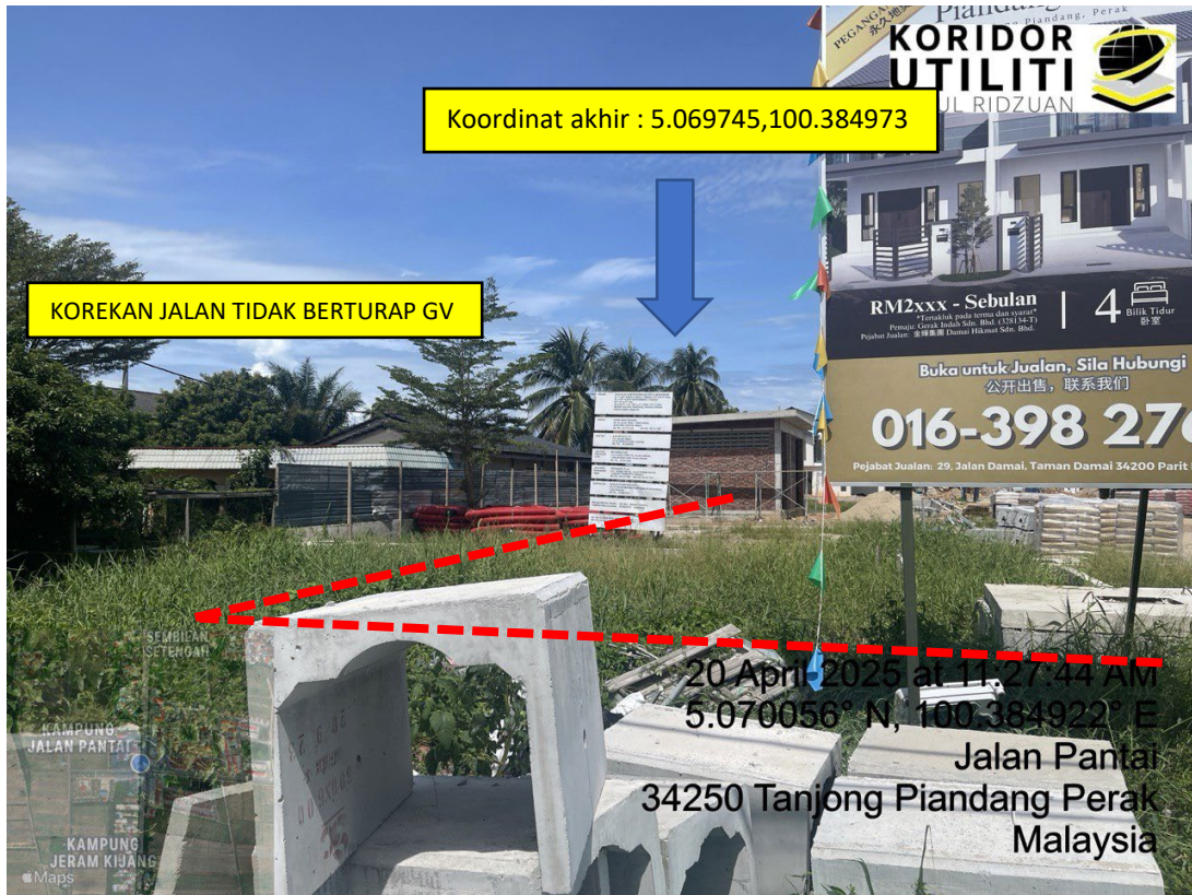
LOKASI DI JALAN PANTAI
