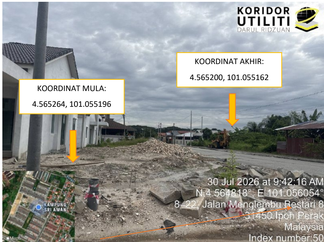
LOKASI DI JALAN MENGLEMBU BESTARI 10 SEPANJANG 8 METER
