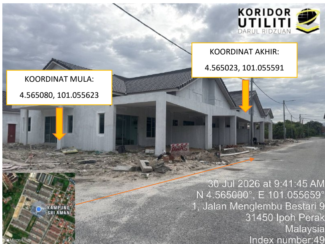
LOKASI DI JALAN MENGLEMBU BESTARI 9 SEPANJANG 7 METER
