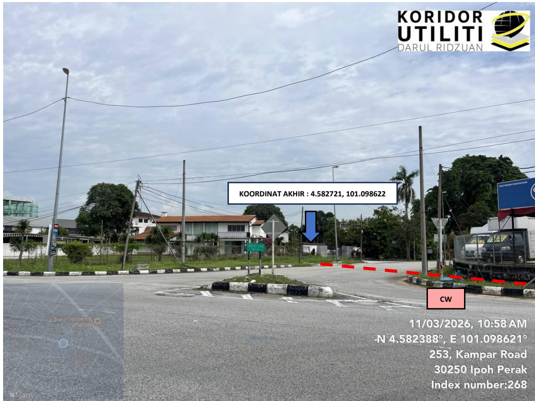
JAJARAN KOREKAN TERBUKA DI JALAN RAJA PERMAISURI BAINUN – JALAN KAMPAR
