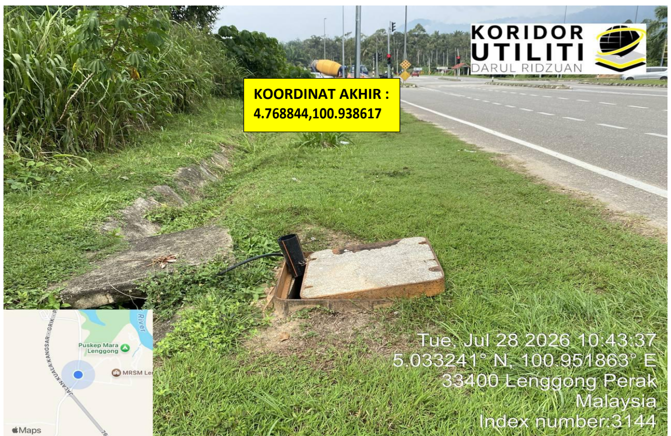
LOKASI DI JALAN LAMA SAUK – LENGGONG (A078)
