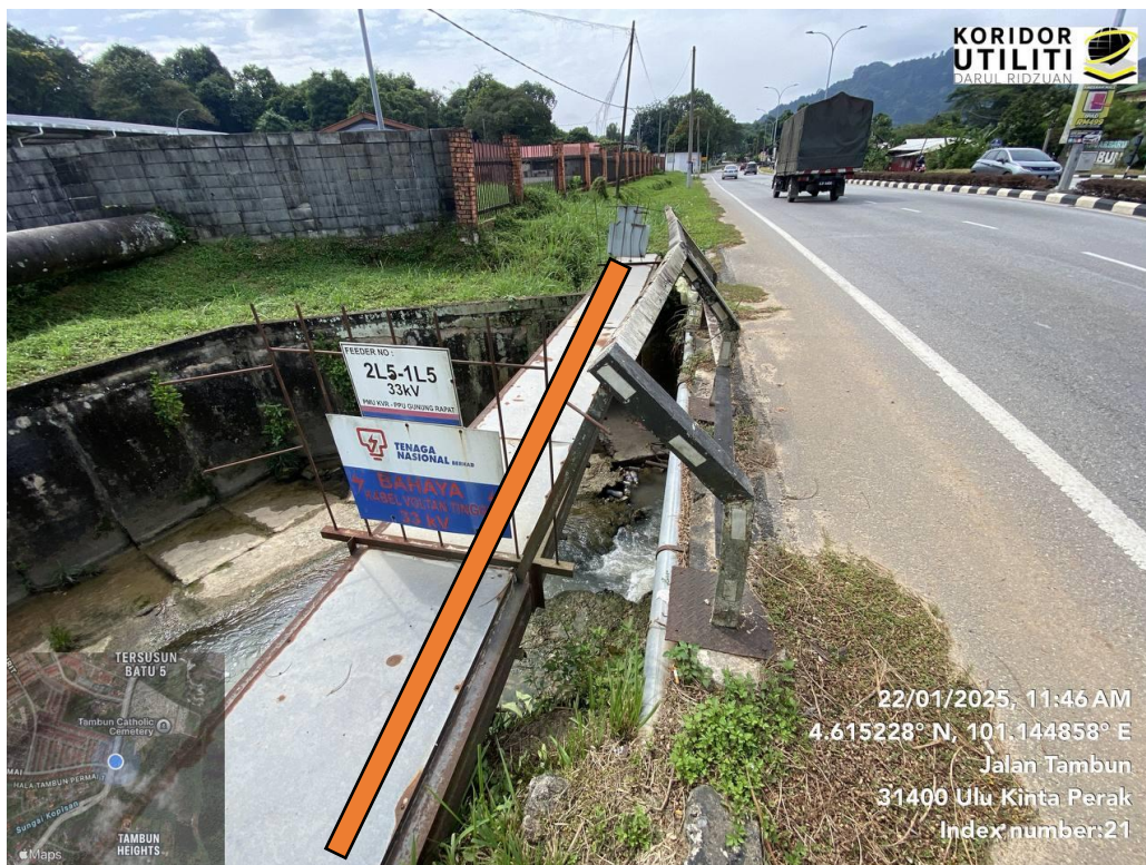
JAJARAN KAEDAH GI DI JALAN TAMBUN (Crossing: Struktur penampung kabel perlu dibuat)
