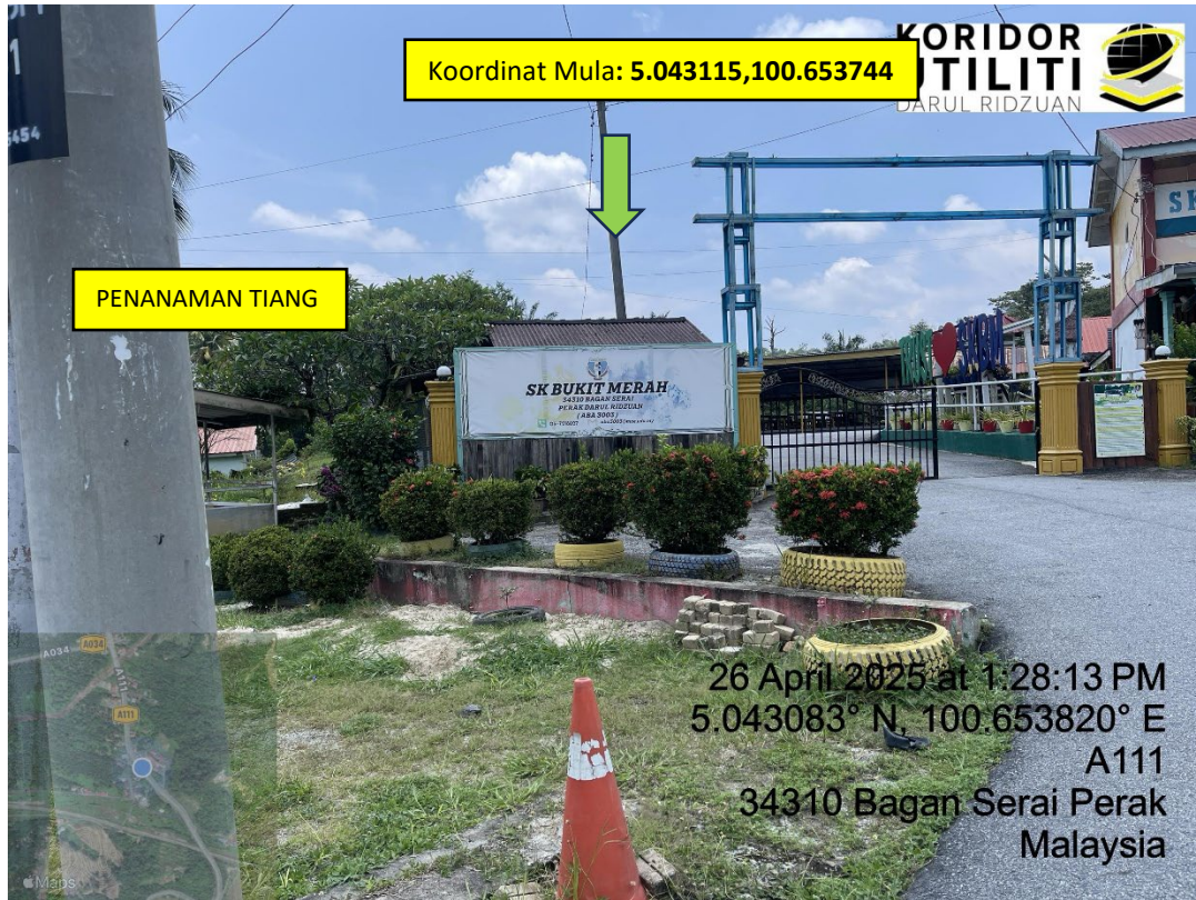
LOKASI DI JALAN SEMANGGOL – CHANGKAT LOBAK
