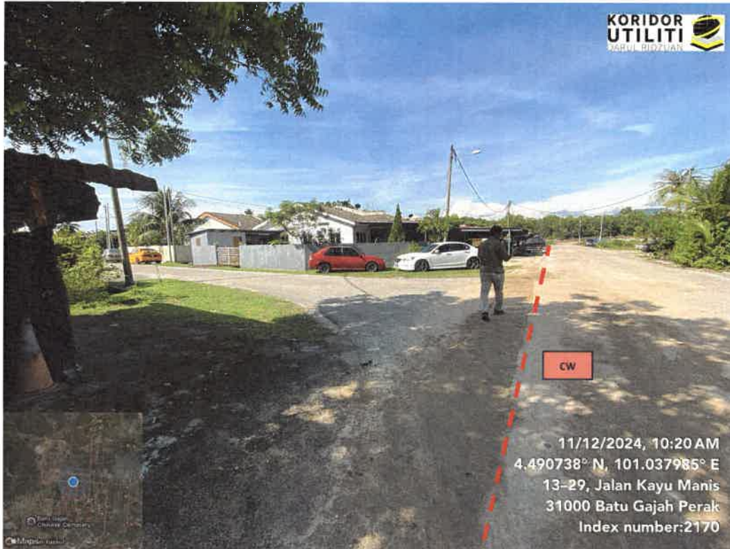
JAJARAN KOREKAN TERBUKA DAN CROSSING 4 JALAN JATI – JALAN KAYU MANIS (Turapan semula akan dilakukan bagi keseluruhan jalan bermula daripada penghujung Jalan Jati hingga ke Jalan Kayu Manis)
