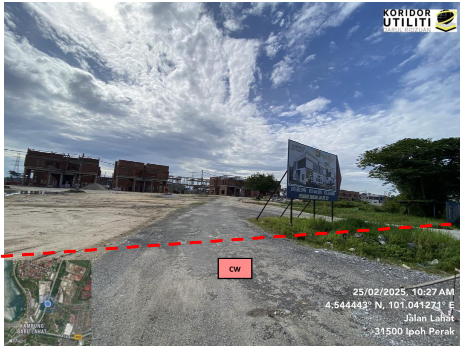
JAJARAN KOREKAN TERBUKA JALAN TIDAK BERTURAP DAN BERTURAP DI JALAN LAHAT (JALAN MILIK JKR)
