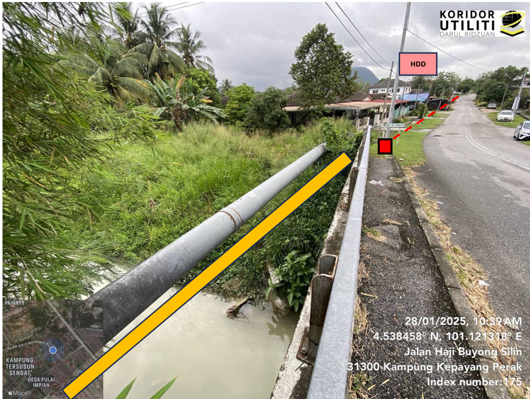
JAJARAN KERJA DI PERSIARAN SENGAT BARU 18 (Crossing Sungai Sengat: Struktur penampung kabel perlu dibuat)
