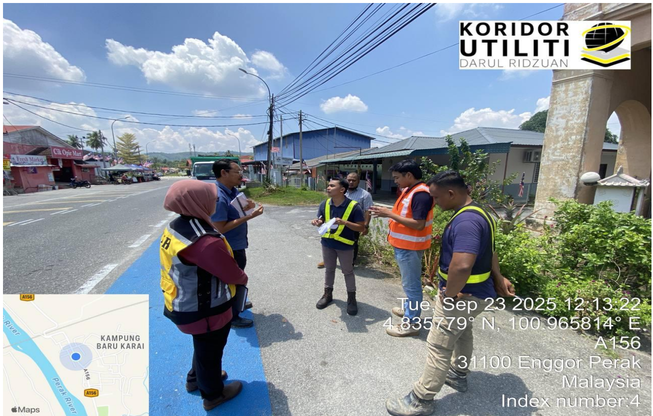
LOKASI DI JALAN KARAI JAWANG TROSOR (A156)
