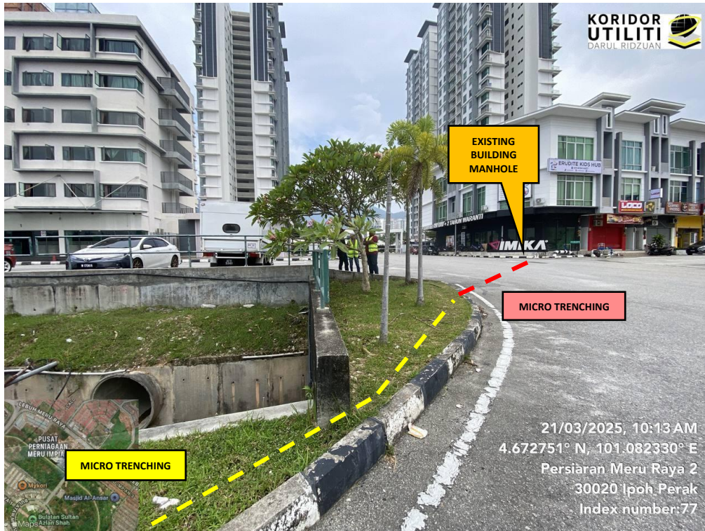
JAJARAN KOREKAN TERBUKA DAN KOREKAN TERBUKA DI JALAN BERTURAP (MICRO TRENCHING) DI PERSIARAN MERU RAYA 2 (Sambungan akan dibuat kepada Existing Building Manhole)
