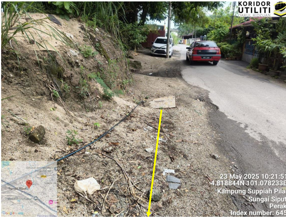
KOORDINAT MULA – TERDAPAT MANHOLE SEDIA ADA. CADANGAN HDD DI JALAN MPKK.
