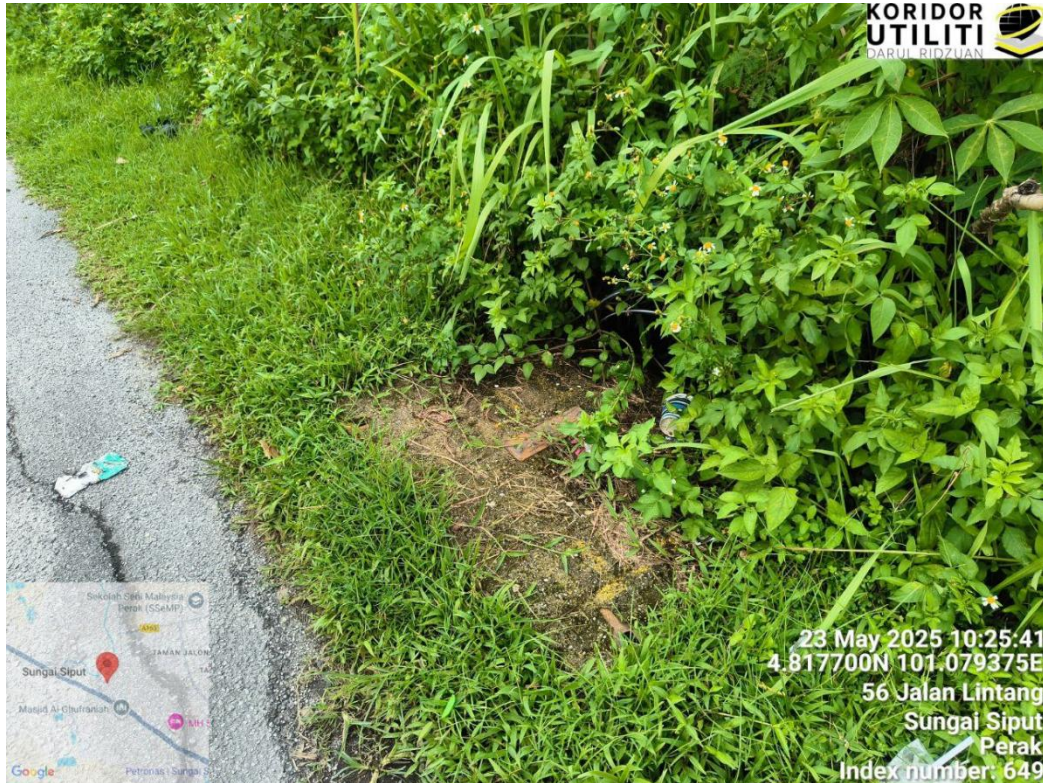
KOORDINAT AKHIR – TERDAPAT MANHOLE SEDIA ADA (JALAN MPKK)
