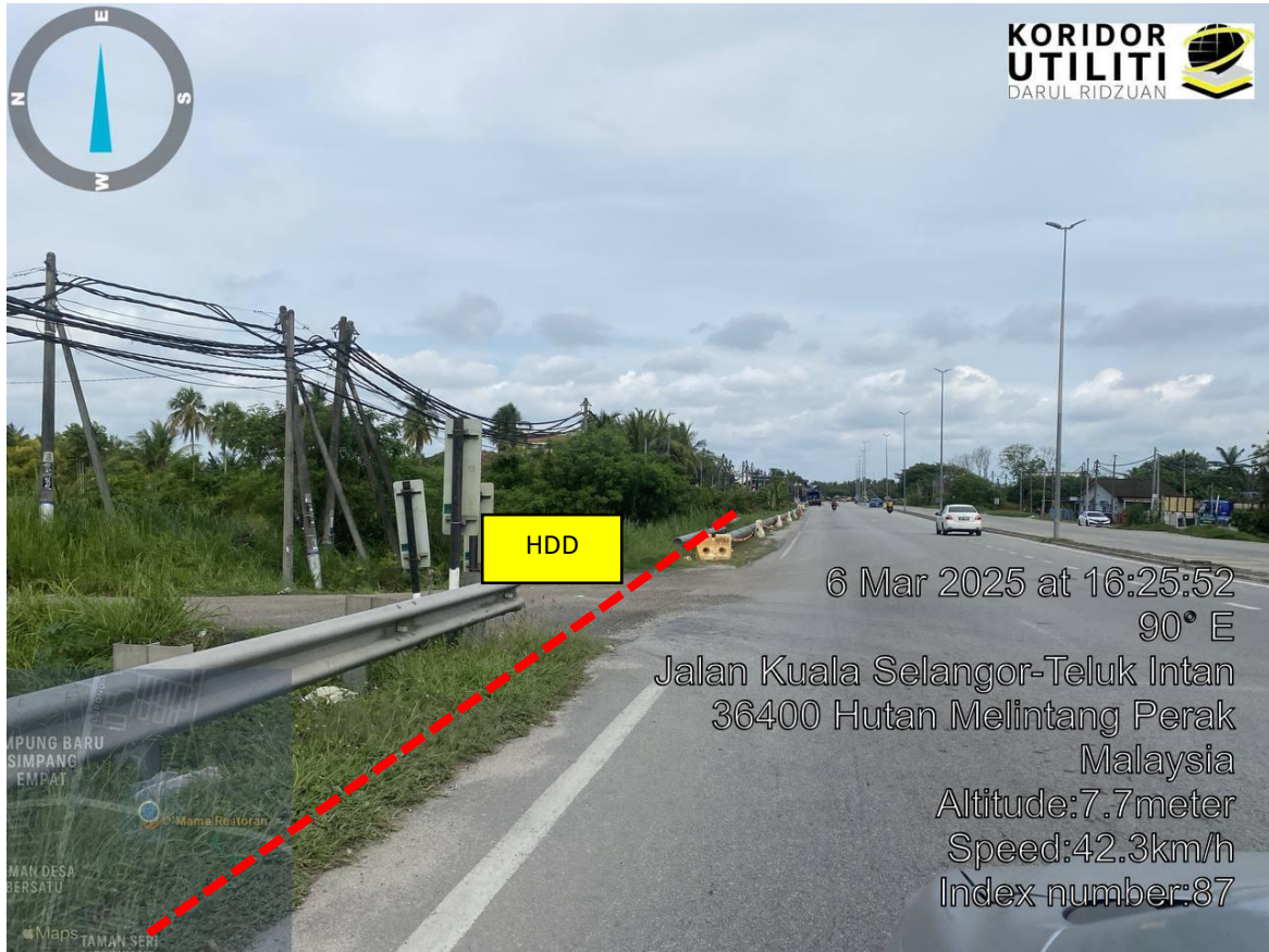
LOKASI DI JALAN KUALA SELANGOR-TELUK INTAN
