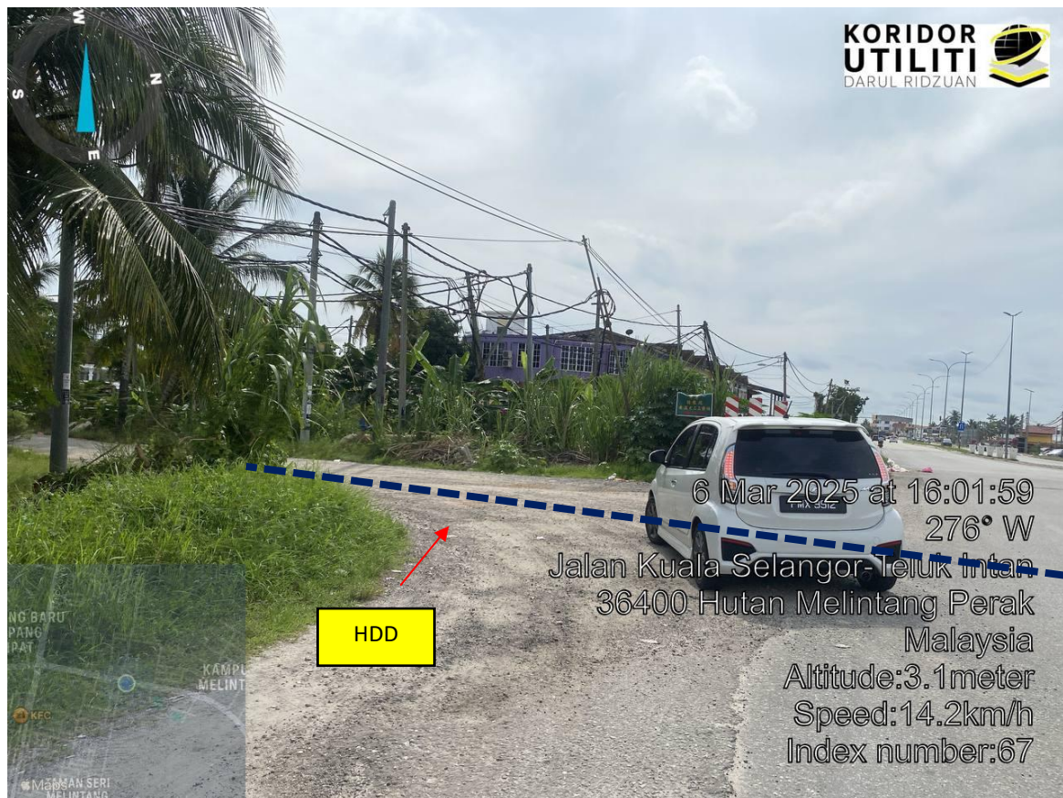
LOKASI DI JALAN KUALA SELANGOR-TELUK INTAN
