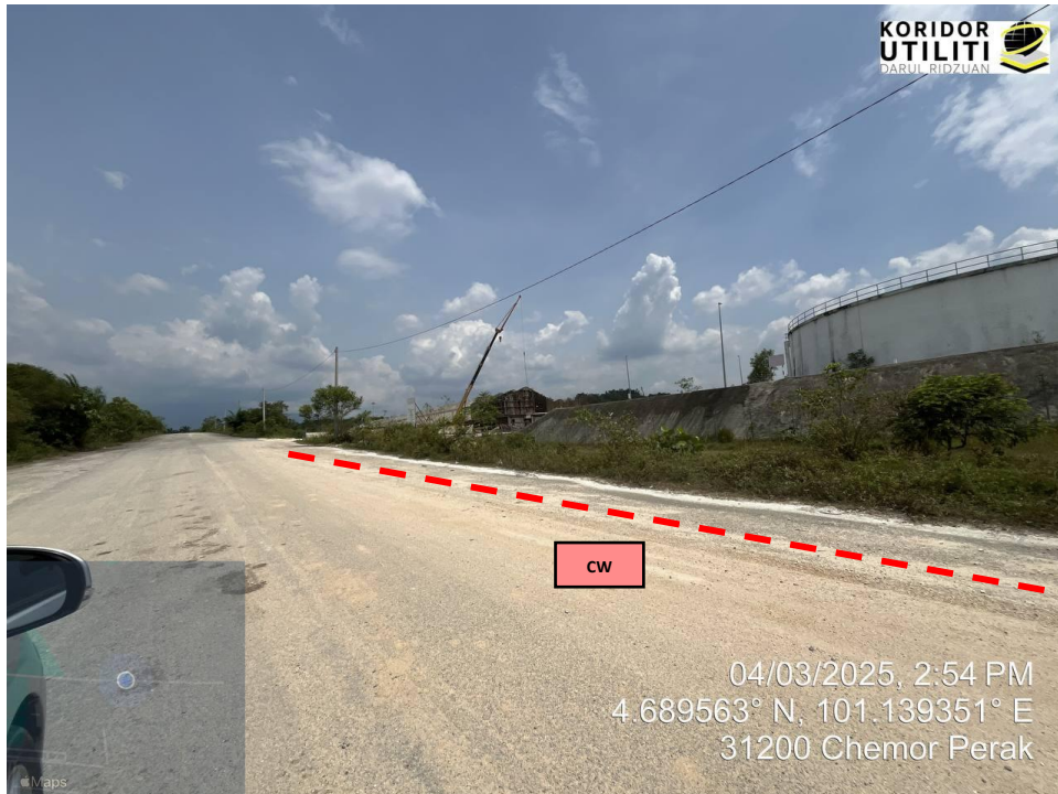
JAJARAN KOREKAN TERBUKA DI JALAN CHEMOR – TG RAMBUTAN
