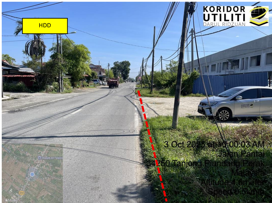
LOKASI DI JALAN PANTAI
