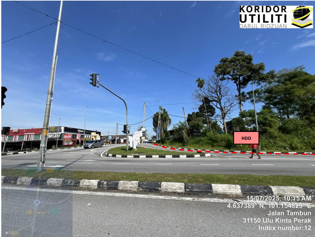
JAJARAN KERJA HDD DI JALAN IPOH – TAMBUN (A013) (JALAN MILIK JKR) MENUJU KE PERSIARAN PERPADUAN UTARA 1 (JALAN MILIK MBI)
