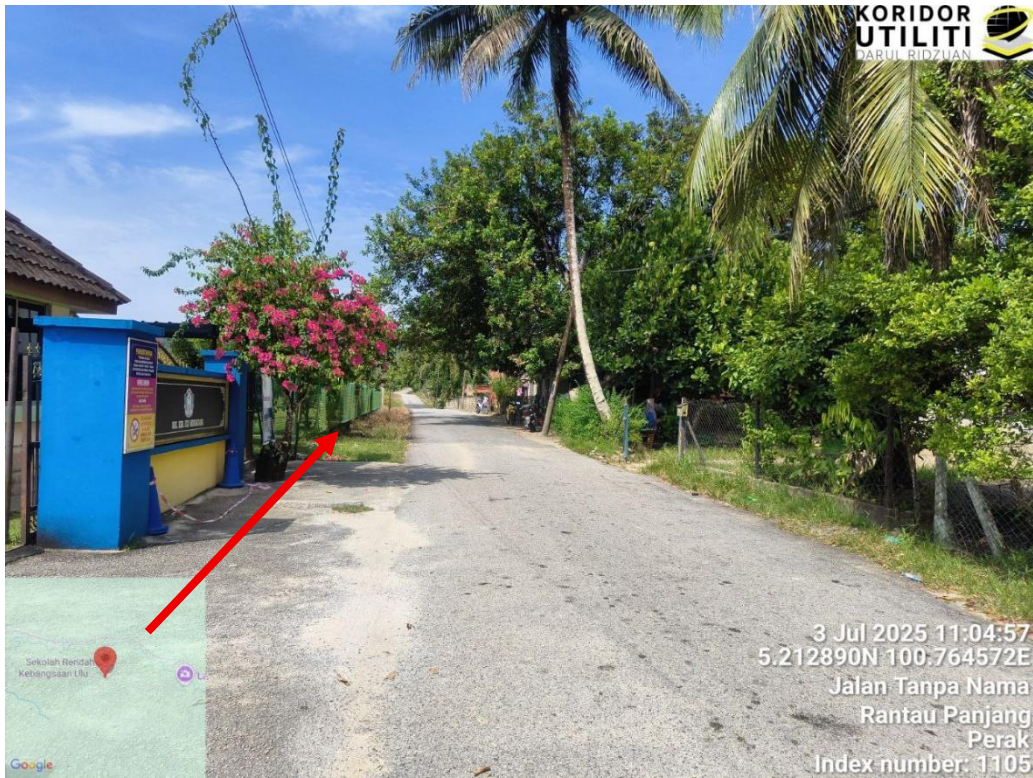
KOORDINAT MULA – CADANGAN PENANAMAN TIANG DI HADAPAN SK ULU MENGGUANG (JALAN PDT)
