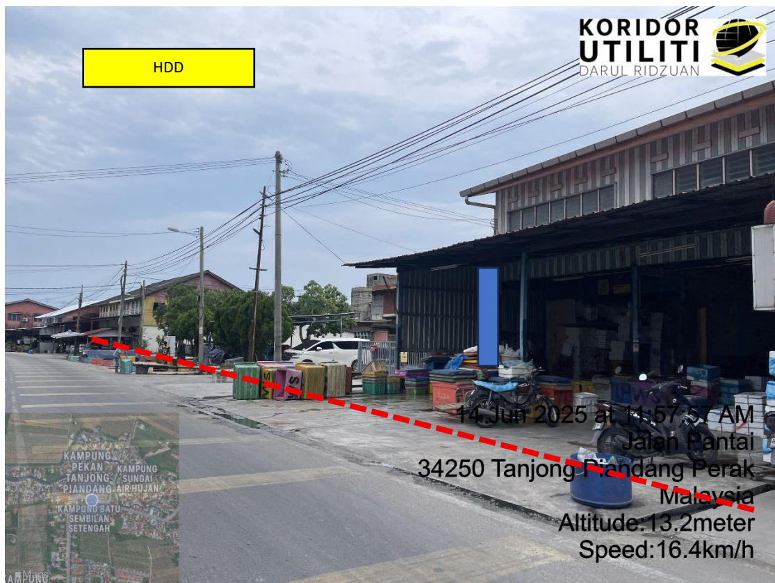
LOKASI DI JALAN PANTAI
