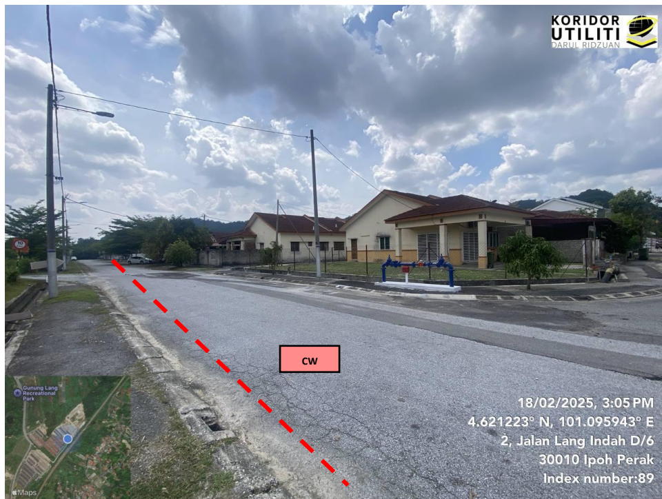
JAJARAN KOREKAN TERBUKA DI LANG INDAH D/2 (LORONG BELAKANG)
