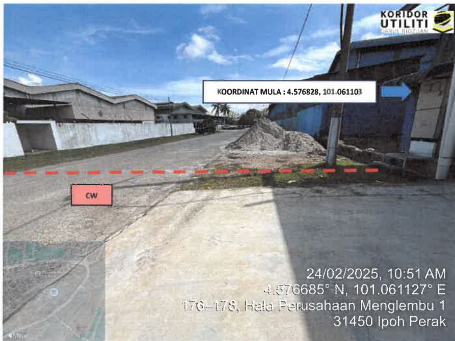
LOKASI KOORDINAT MULA KOREKAN TERBUKA JALAN BERTURAP DI HALA PERUSAHAAN MENGLEMBU 1
