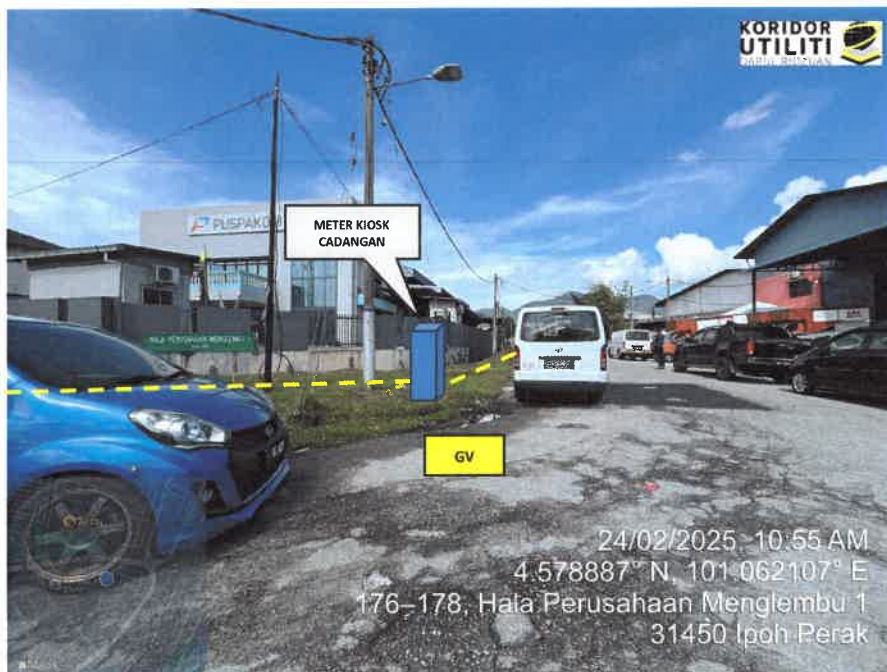
AJARAN KOREKAN TERBUKA JALAN TIDAK BERTURAP DI HALA PERUSAHAAN MENGLEMBU 1
