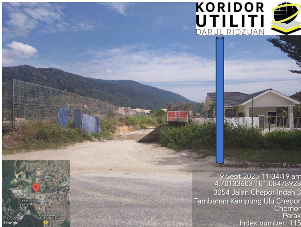
LOKASI KOORDINAT MULA KOREKAN HDD DI JALAN SERUAN – JALAN SULTAN NAZRIN SHAH (Sambungan daripada Existing Maxis Manhole)
