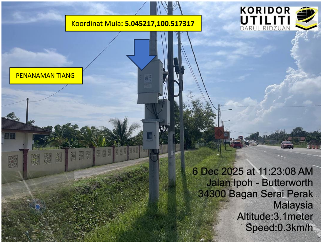
LOKASI Di JALAN TAIPING- BAGAN SERAI
