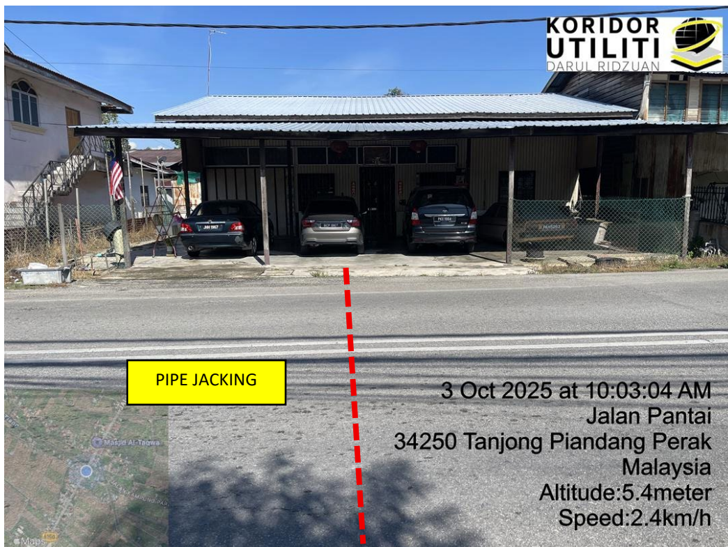
LOKASI DI JALAN PANTAI
