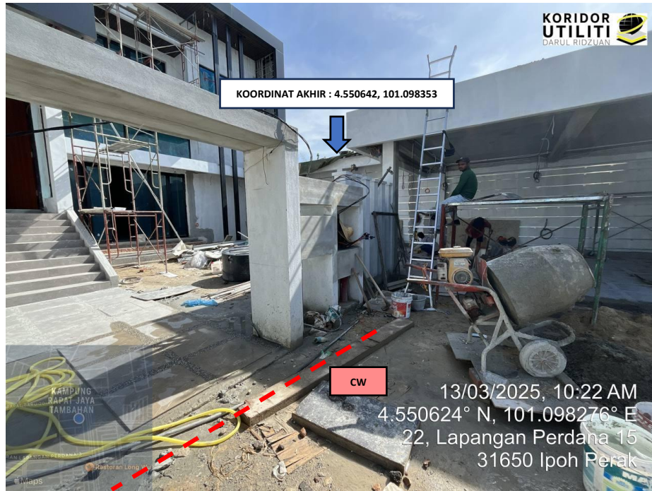
LOKASI AKHIR KOREKAN TERBUKA DI JALAN LAPANGAN PERDANA 15 (Sambungan akan dibuat daripada tiang TNB sedia ada kepada meter panel)
