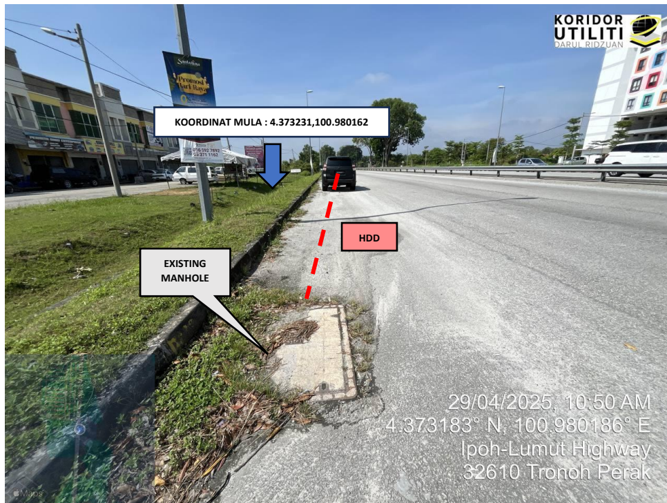
LOKASI KOORDINAT MULA KERJA HDD DI LEBUHRAYA IPOH – LUMUT (FT.05) (SAMBUNGAN DARIPADA EXIST MH 1 KE EXIST MH 2)
