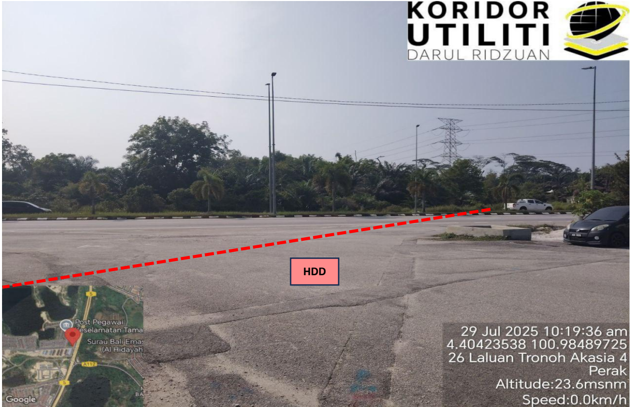
LOKASI KERJA-KERJA KOREKAN HDD TERBUKA DI IPOH-LUMUT HIGHWAY (FT5) KE JALAN MASUK TRONOH AKASIA
