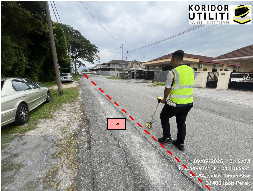
JAJARAN KOREKAN TERBUKA JALAN BERTURAP DI JALAN TAMAN STAR
