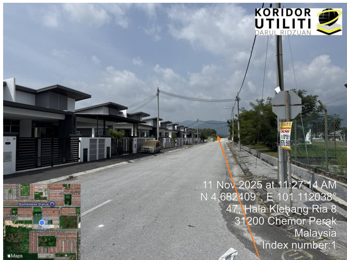
KOREKAN TERBUKA DI JALAN BERTURAP
