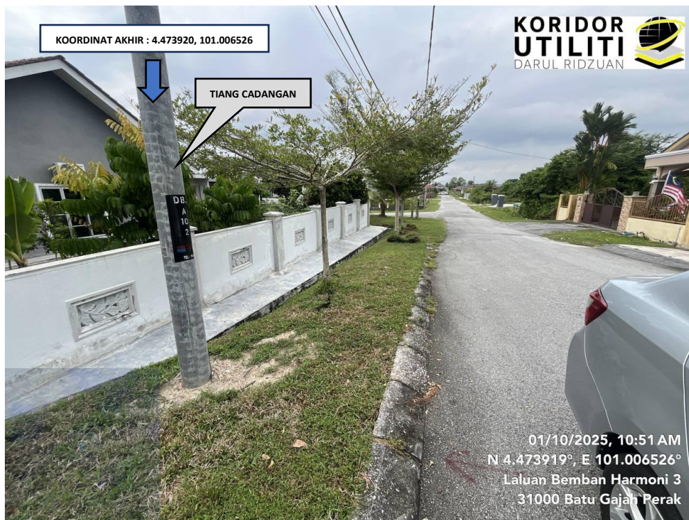
LOKASI KOORDINAT AKHIR PENANAMAN TIANG DAN PENARIKAN KABEL DI LALUAN BEMBAN JAYA 1
