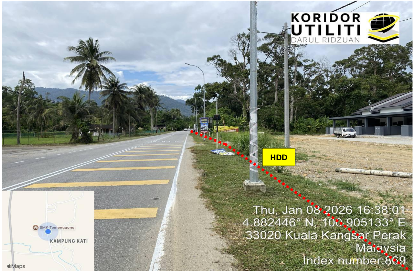
LOKASI DI JALAN LAMA PEKAN KATI (A219)
