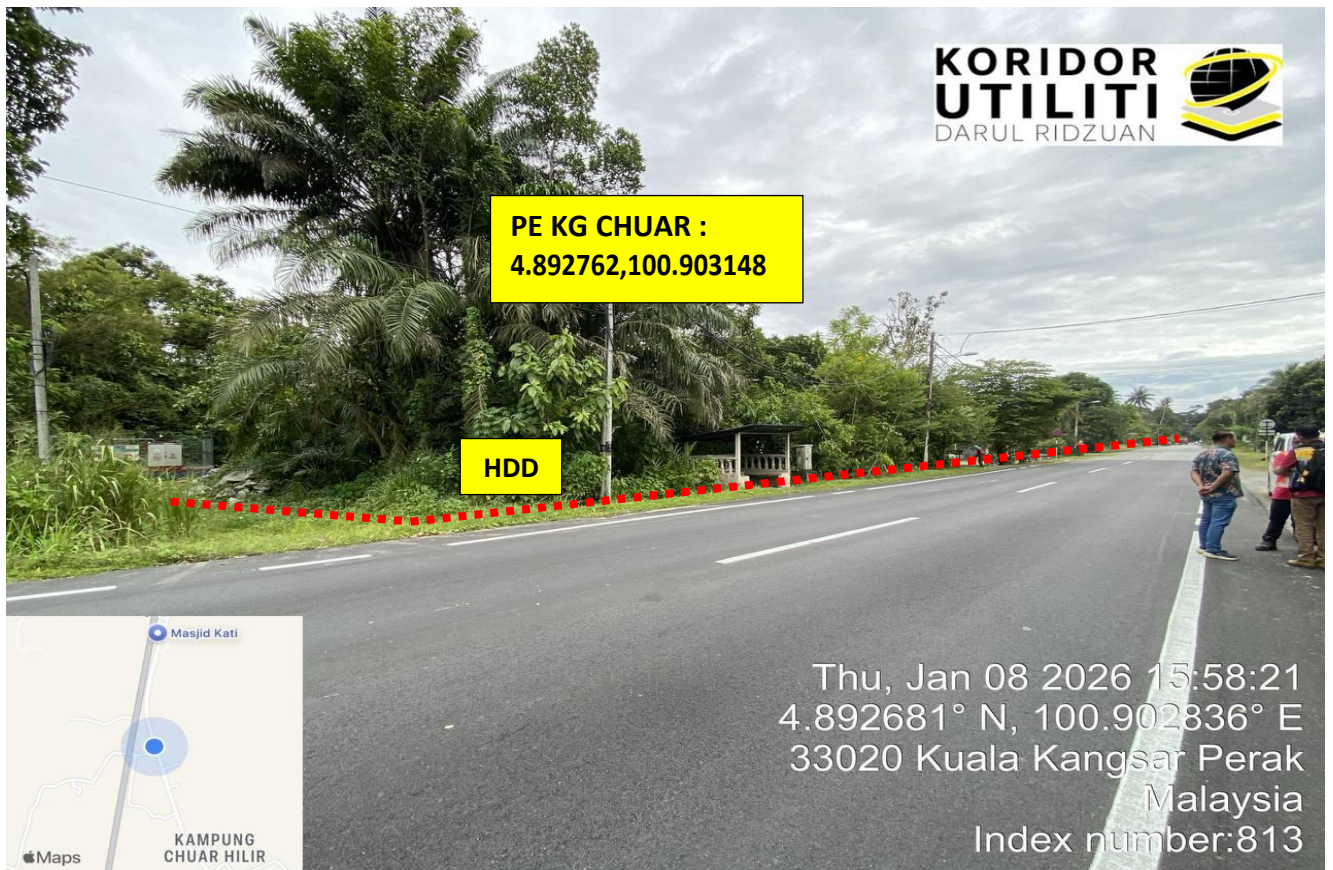
LOKASI DI JALAN LAMA PEKAN KATI (A219)
