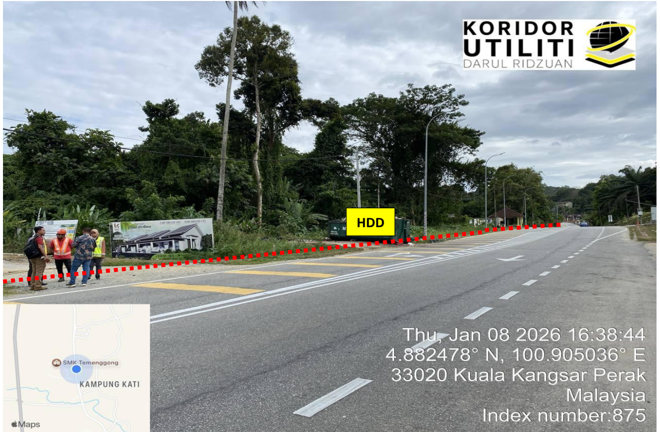
LOKASI DI JALAN LAMA PEKAN KATI (A219)
