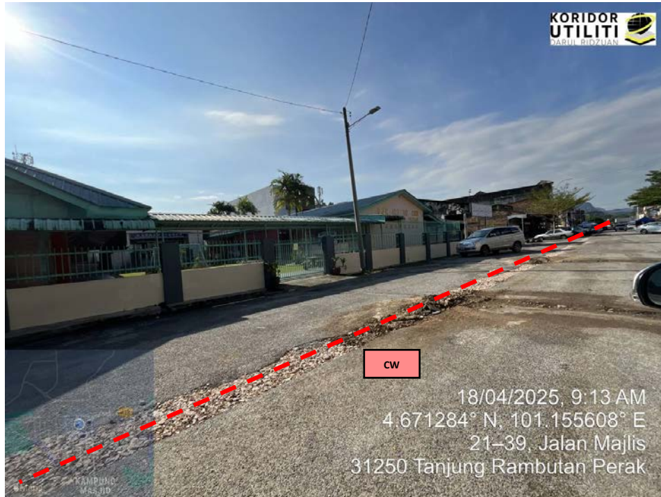
JAJARAN KOREKAN TERBUKA DI JALAN MAJLIS
