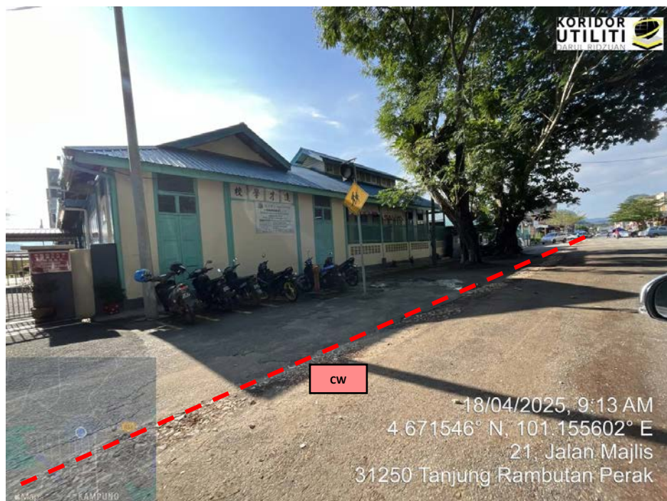
JAJARAN KOREKAN TERBUKA DI JALAN MAJLIS
