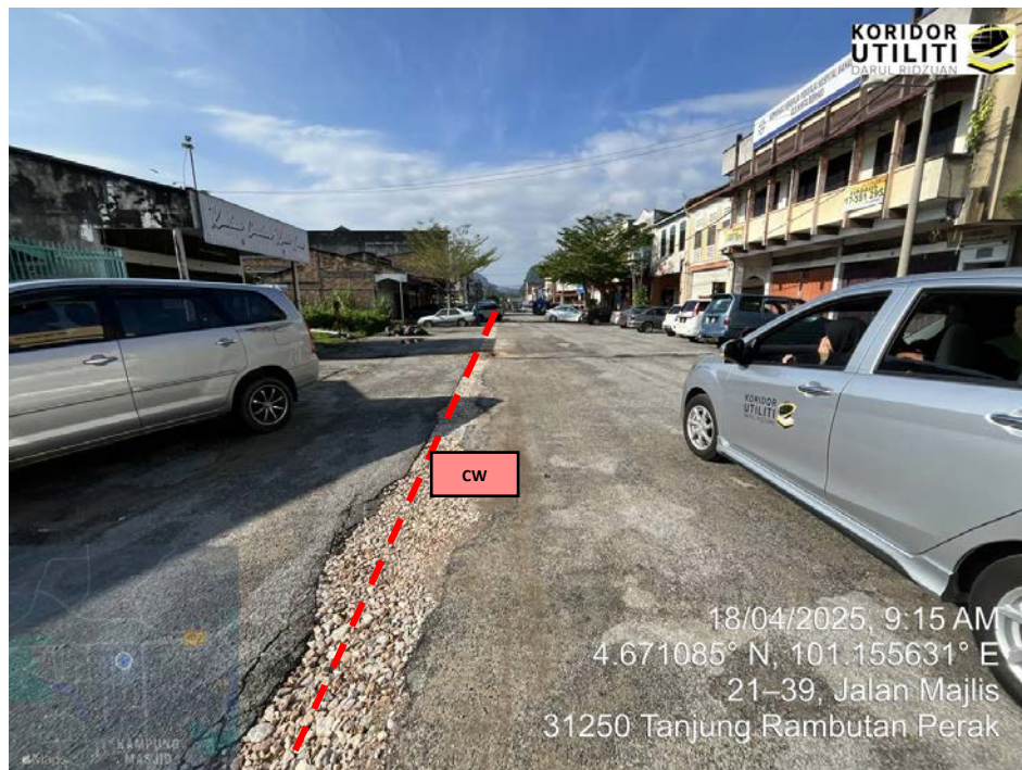
JAJARAN KOREKAN TERBUKA DI JALAN MAJLIS
