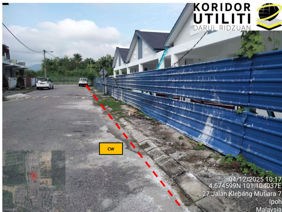
JAJARAN KOREKAN TERBUKA DI JALAN KLEBANG MUTIARA 9
